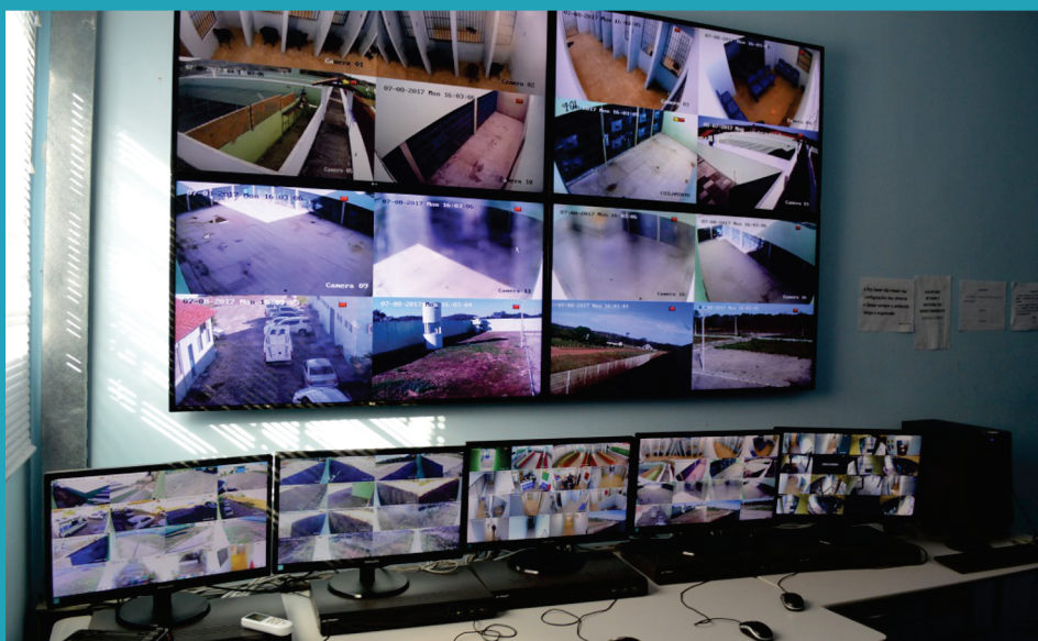
Sistema de Câmeras da Casa de Detenção de Altos
